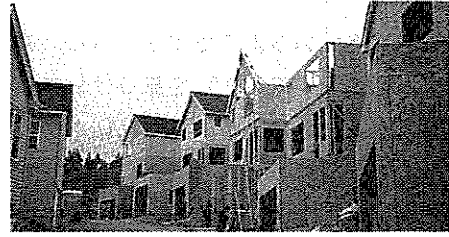
写真2：2×6の施工風景、写真1の上にランバー壁で枠組壁を造っていく、日本でのアメリカン住宅もほぼこのように建てられる。なお、外壁はサイディングが目立つ。
