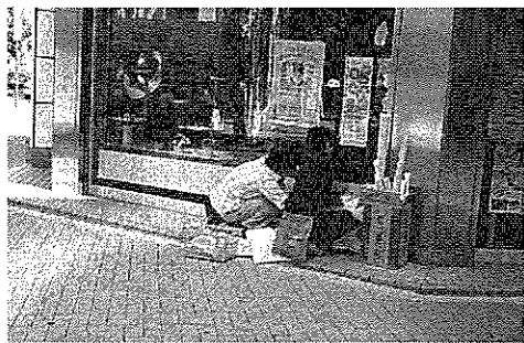
場所ごとにあらかじめカットされたシートを貼っていく。ここではショーウィンドーに設置中。
