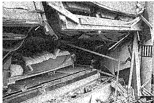
救助跡が生々しく残る倒壊建物（富島地区）
