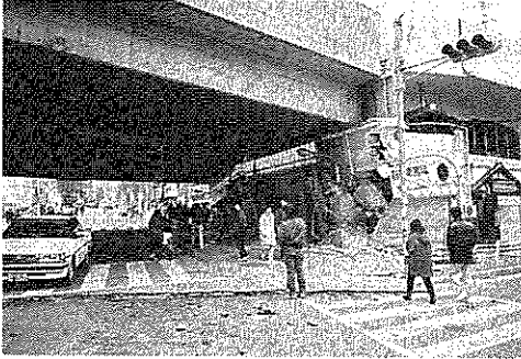
私が通っていた六甲道駅は、柱が爆裂し、桁が落ちた。高架下に入っていた行きつけのパン屋もつぶれてしまった。
