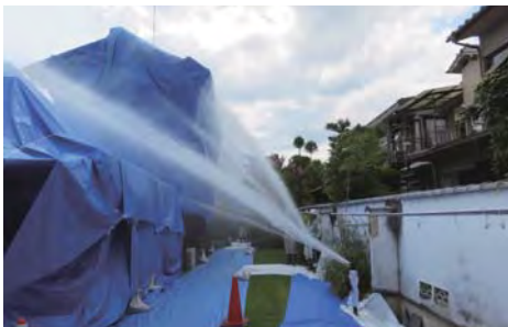
延焼防止ライン試験放水
