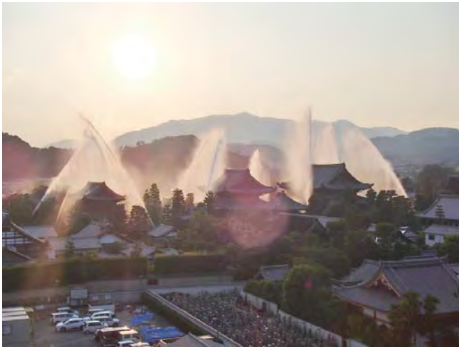
中心伽藍放水銃試験放水
