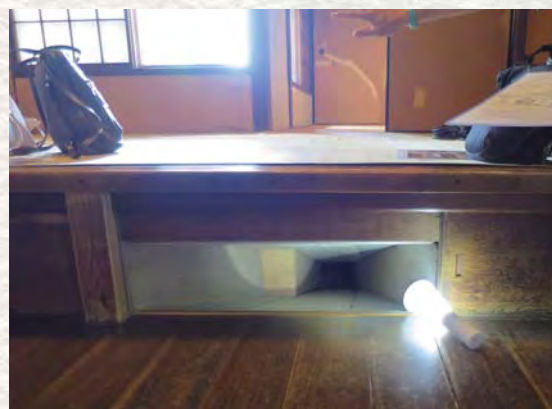
写真1：導気口（クールキューブ）の様子
