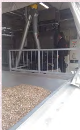
バイオマスボイラーと竹チップ
